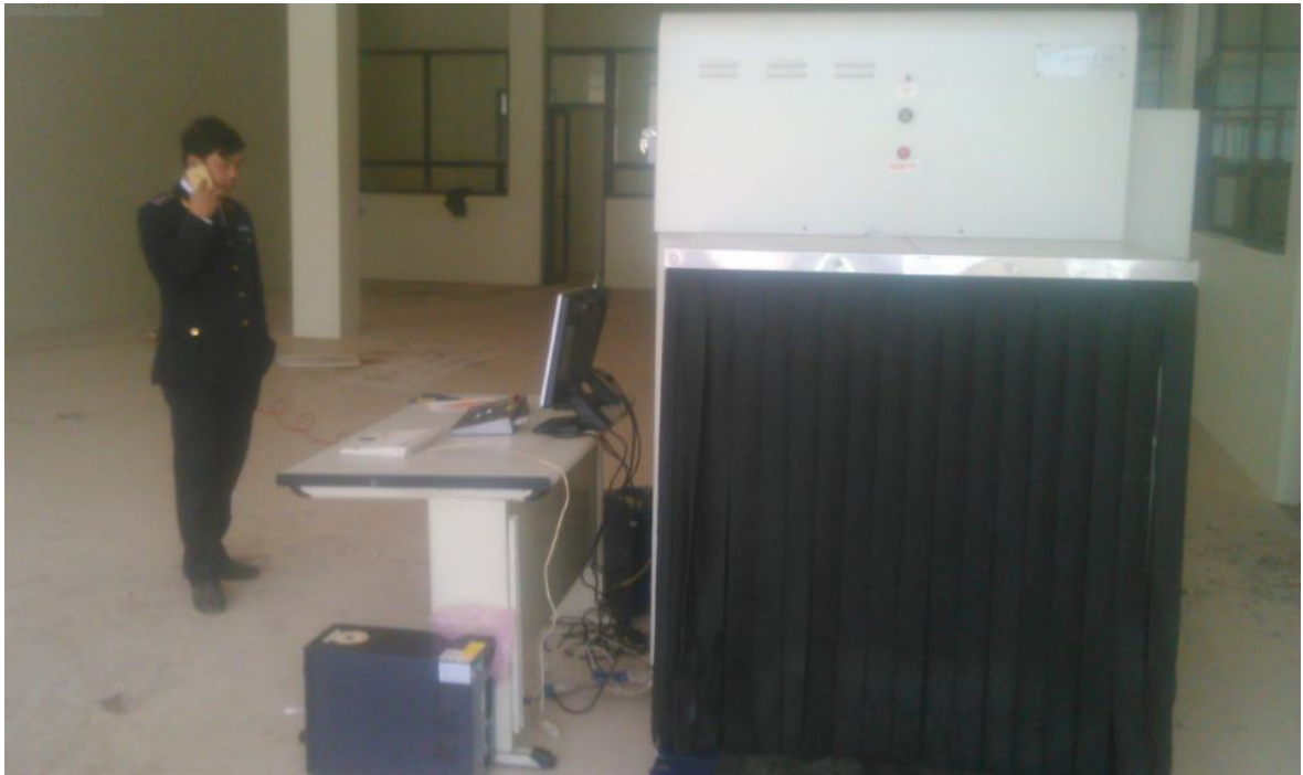
Lắp đặt máy soi Hải quan tại cửa khẩu Chalo - Quảng bình
